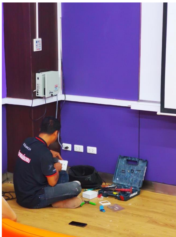
ติดตั้งสาย HDMI เพิ่มเติมในห้องฉายภาพยนตร์ ชั้น 4 ศูนย์วิทยบริการ
